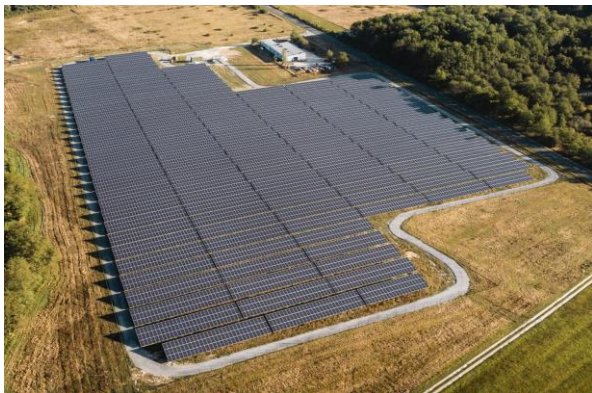
Centrale photovoltaïque Enoé de Saint-Julien-sur-Cher
